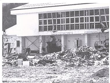
避難所の外観も一部崩れ、瓦礫の山に
