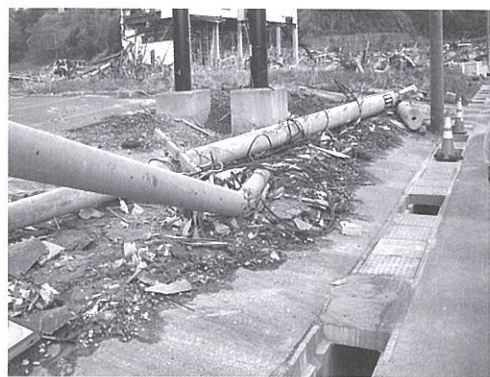
ぼっきり折れた電信柱。見渡す限り立っている電信柱はない。
